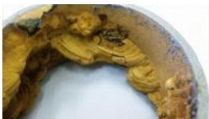
ACR 設置前の配管内部
