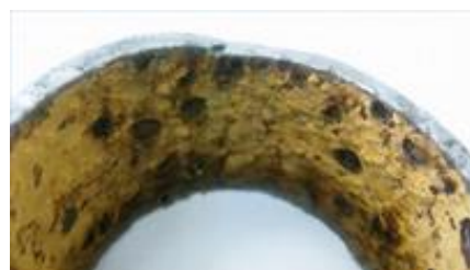
ACR 設置 4 ヶ月後の配管内部
