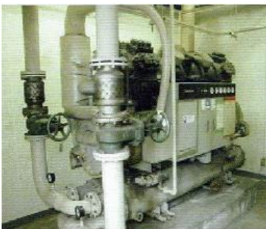
空調用冷凍機
