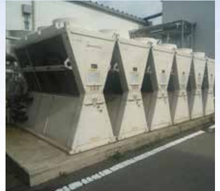
チラーユニット
